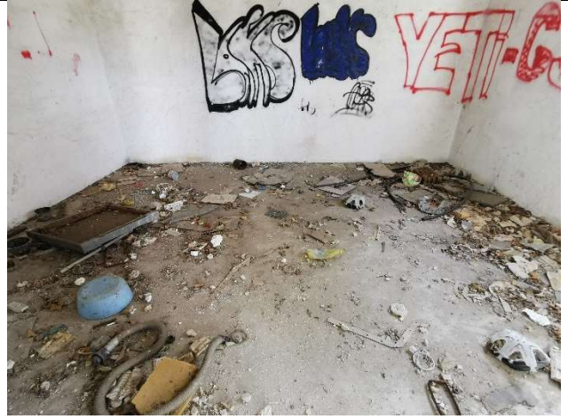
Szennyezőforrás III. – Egykori kiszolgáló épületben vegyes hulladékok
