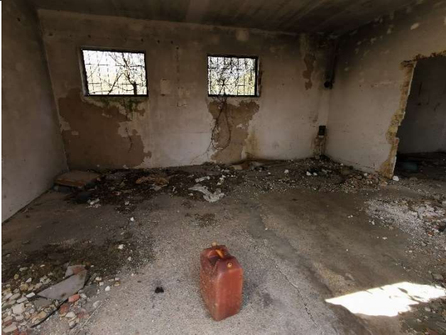
Szennyezőforrás III. – Egykori kiszolgáló épületben olajos kanna
