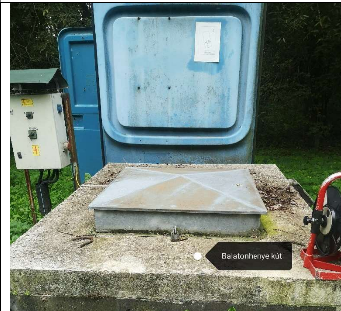
Balatonhenyei kút (Csurgó-forrás) akna
